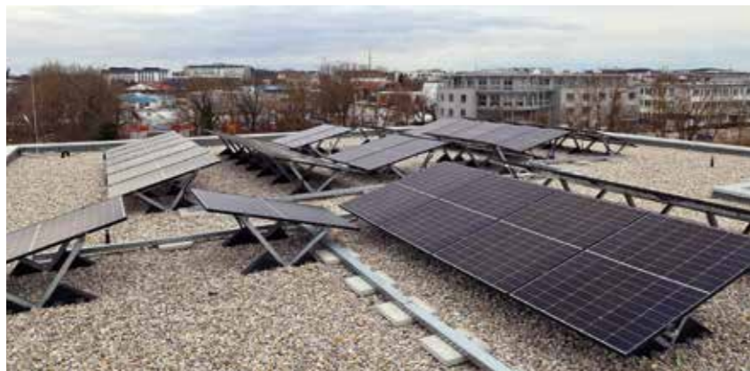
Schwarze Solarzellen auf dem Dach des Caritas Kinderhorts – in verschiedenen Winkeln zur Sonne ausgerichtet, um zu unterschiedlichen Tageszeiten Energie einzufangen. Die Solarinitiative der Stadt soll für viele weitere solche Photovoltaikanlagen sorgen
